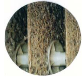
汚泥付着状態
